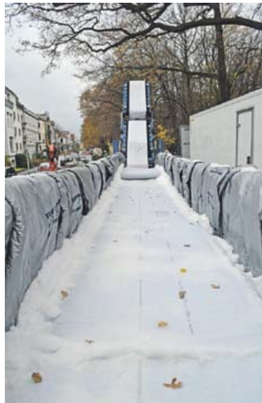
Ein 225 Meter langer und 16 Tonnen schwerer Liner wartet gut gekühlt auf seinen Einbau.
